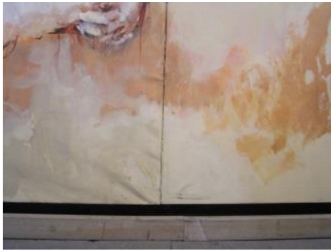
Detalle de pliegues de mal tensado
